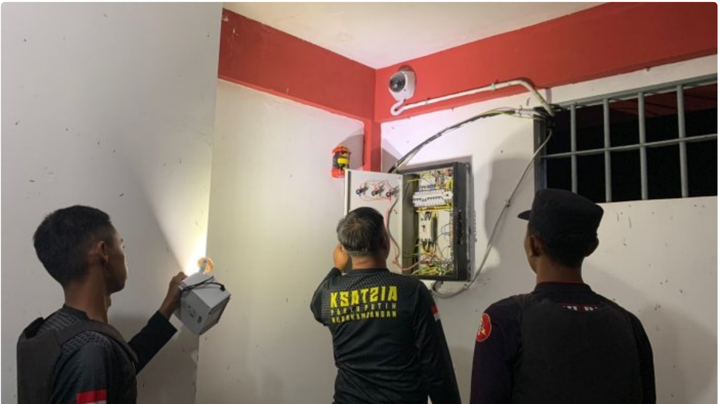
Pengecekan jaringan listrik antisipasi terjadinya korsleting listrik oleh petugas Lapas Pasir Putih
